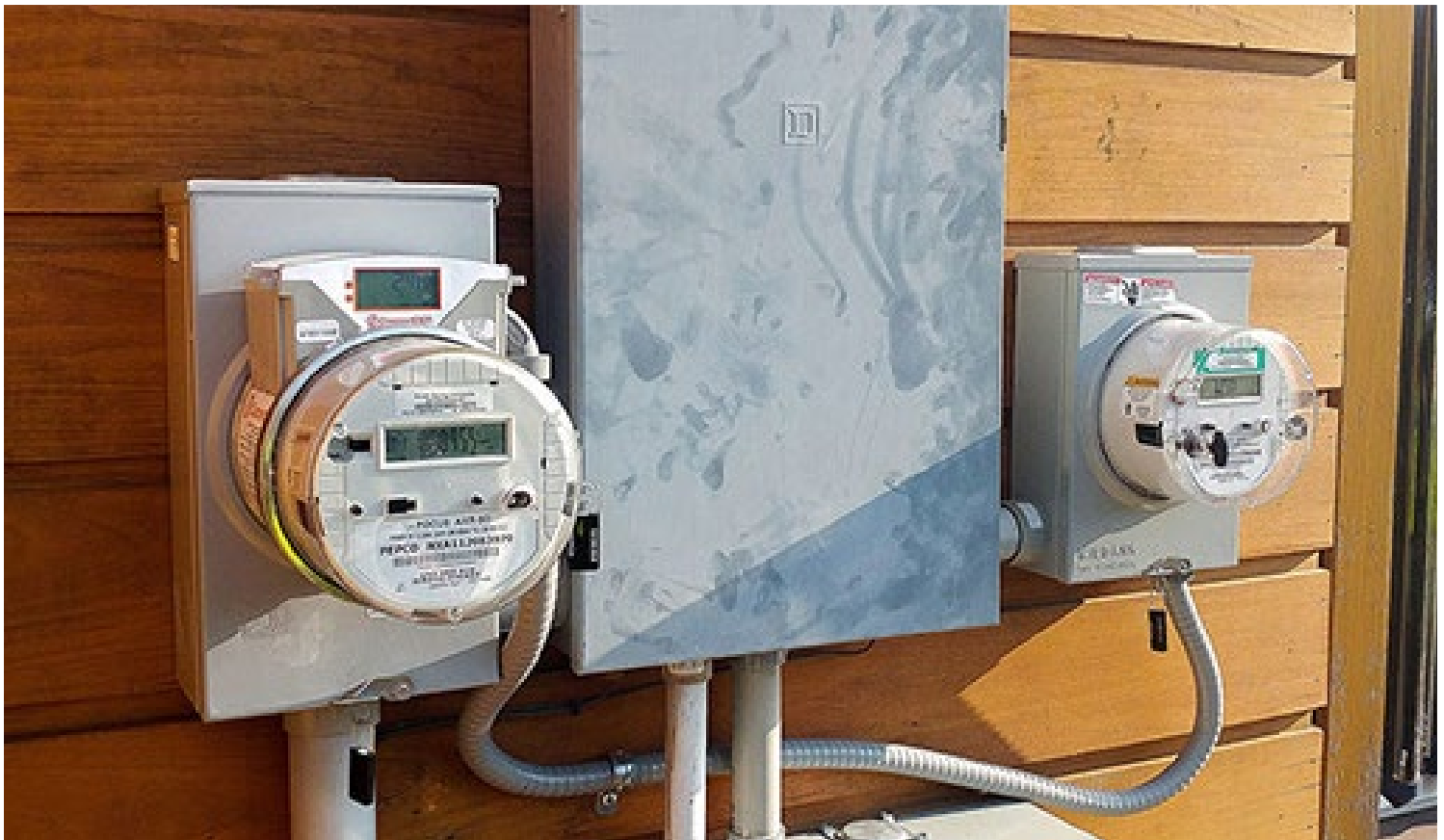
Con Ed's DER meter, ConnectDER | Con Edison
