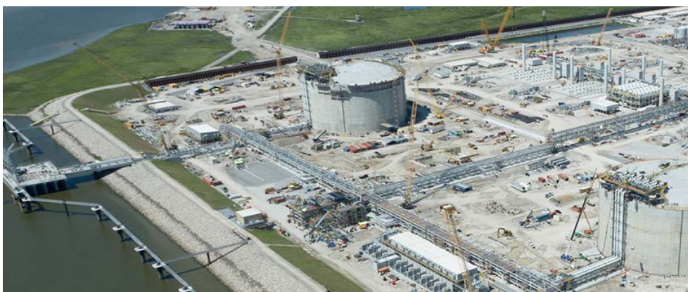
Calcasieu Pass LNG Facility | Venture Global LNG
