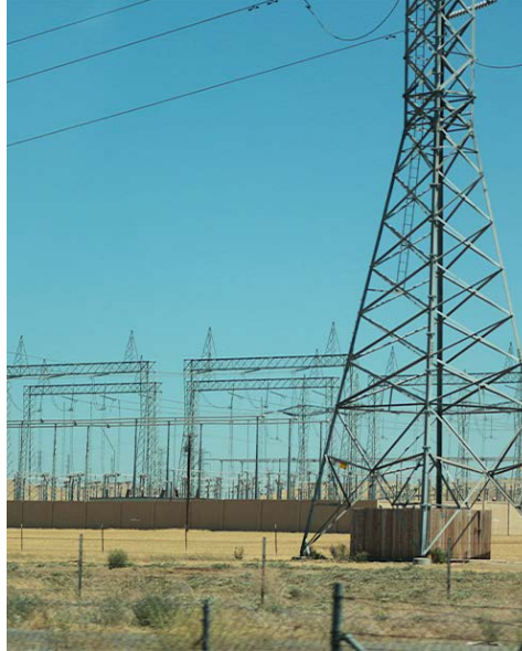
Los Banos Substation in California | JPxG, CC BY-SA 4.0, via Wikimedia Commons
